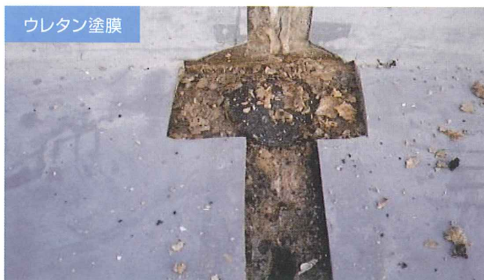
■ウレタン塗膜防水のコンクリート躯体の劣化・カビ発生
